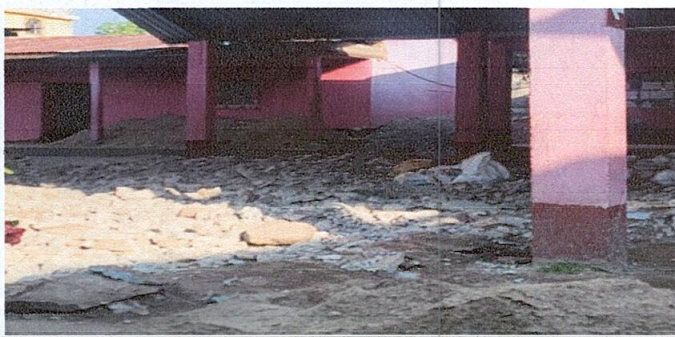
Foto 5: piso dañado en proceso de ejecución
