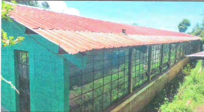
Foto1: Deterioro y perforación de lámina y capotes.
