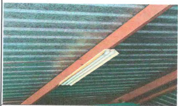
Foto 8: Candelas quemadas en el sistema eléctrico.
