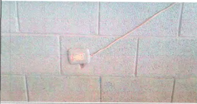
Foto 7: Deterioro de tomacorrientes
