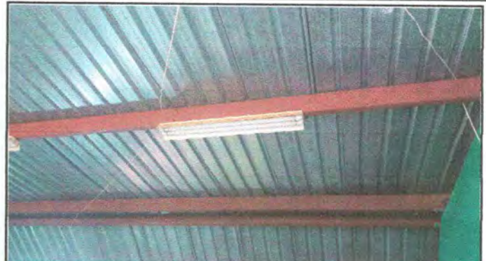
Foto 2: Oxidación y deterioro de costaneras
