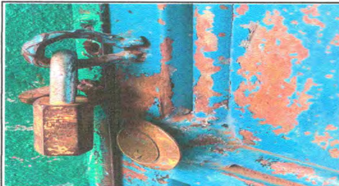
Foto 3: Deterioro y desperfecto de chapas
