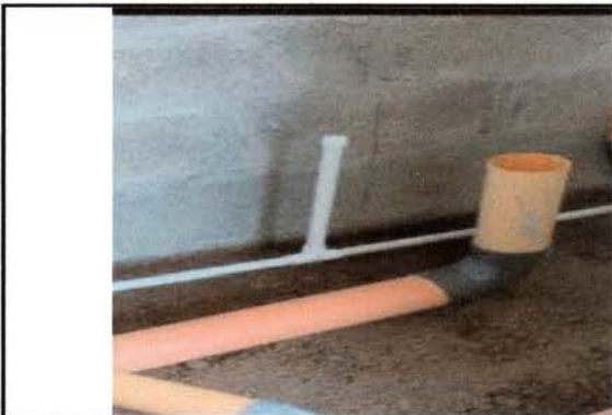
Foto 9: Red de agua potable en baños
