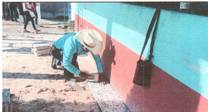
Foto 4: Sustitución de piso de granito en mal estado.
