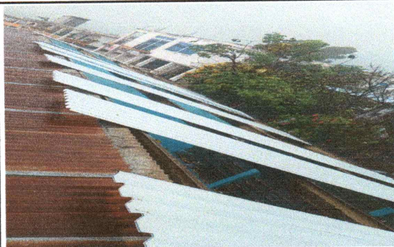
Foto1: Lámina deteriorada por cambiar
