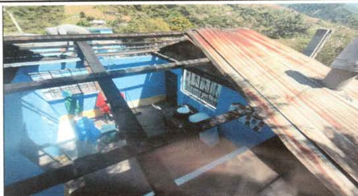
Foto1: Lámina antigua retirada del techo de la cocina
