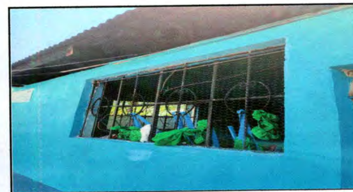
Foto 6: Ventanales de cocina sin vidrios.
