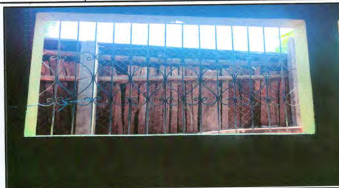
Foto 8: Aulas sin ventanales
