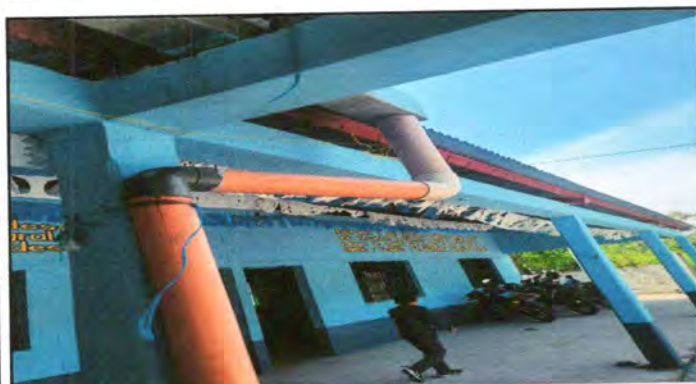
Foto 9: Canales en mal estado
