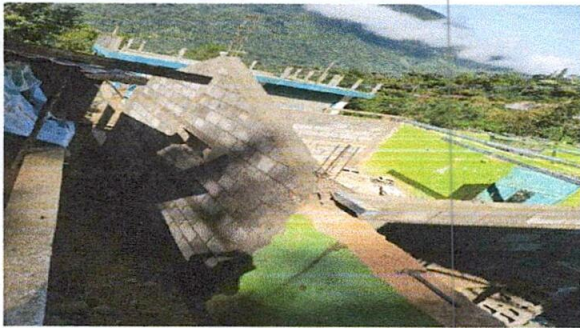
Foto 1: lámina en malas condiciones
