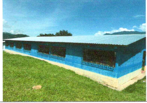
Foto 2: Sustrucción de pintura en interiores y exteriores en malas condiciones.
