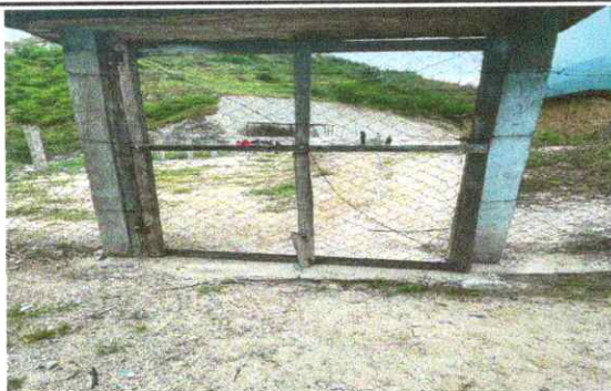
Foto 1: Portón de ingreso en deterioro
