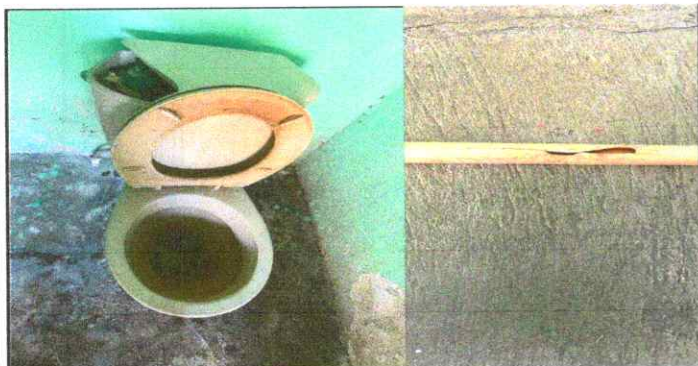
Foto 3: Servicio sanitario en mal estado
