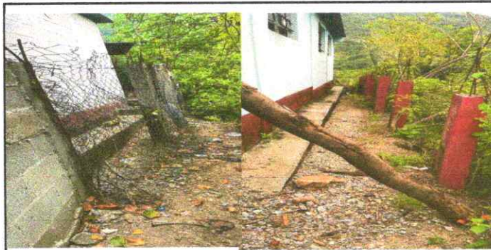
Foto 4: Circulación en mal estado
