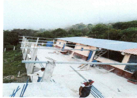
Foto 2: lamina a cambiar
