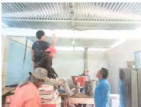
FOTO 1: REPELLO EN COCINA
