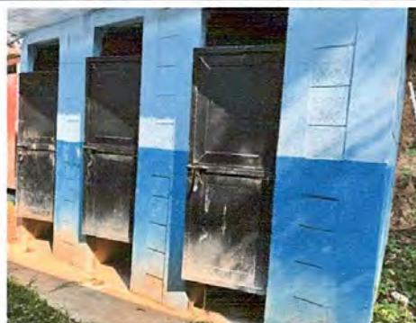
FOTO 10: PINTURA ANTICOROSIVO EN PUERTAS
