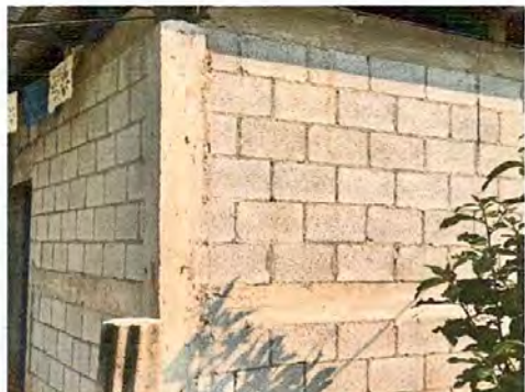
FOTO 1: REPELLO EN COCINA
