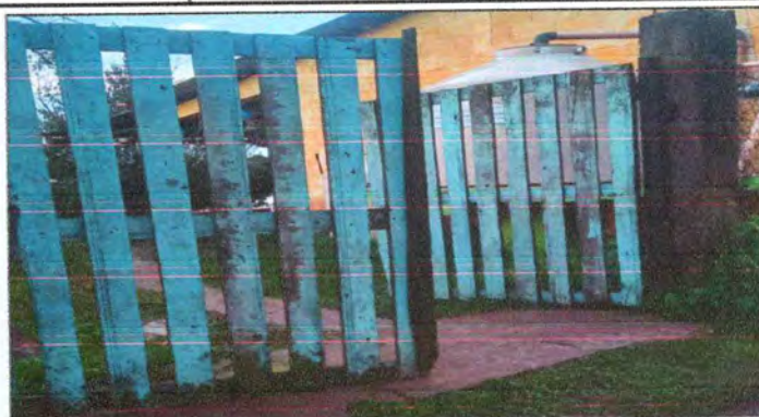
Foto 2: Porton de estructura de madera a sustituir
