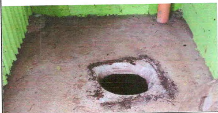
Foto1: Baños en malas condiciones
