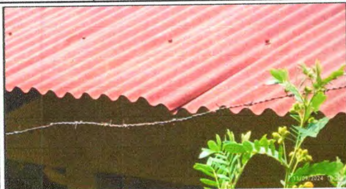
Foto 1: Lámina en mal estado a sustituir
