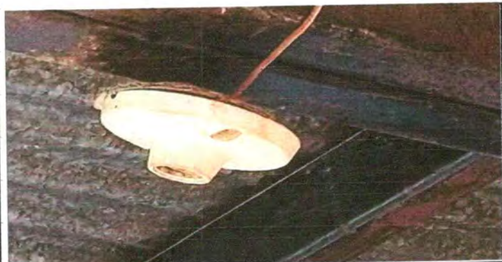
Foto 5: Electricidad y estructura de soporte
