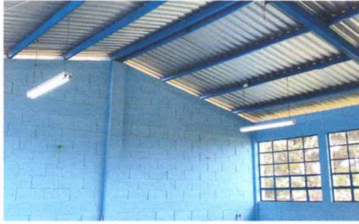
Foto1: Candelas de lámparas circuitadas instaladas
