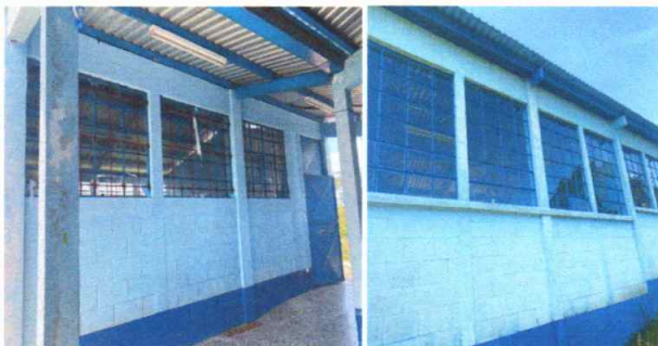
Foto 3: Balcones inadecuados en aula de computadoras y de aulas expuestas
