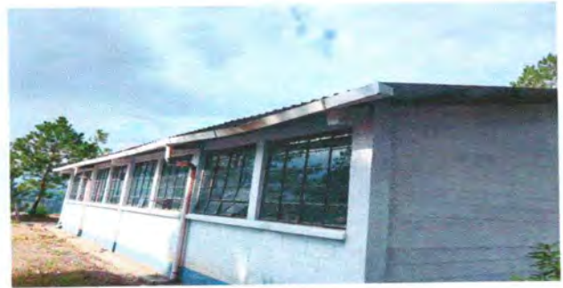
Foto 2: Ventanas expuestas falta de balcón
