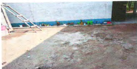
Foto 1: Plancha de concreto dañado
