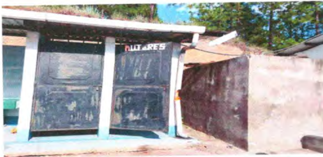
Foto 3: Canales de PVC deteriorados
