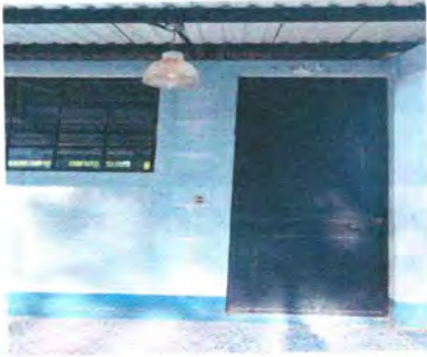
Foto1: Puertas en aula en mal estado
