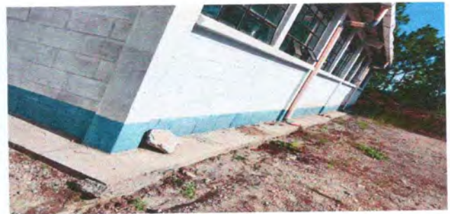
Foto 4: Banqueta de concreto dañado
