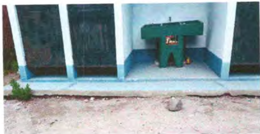
Foto 3: Pila en mal estado
