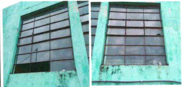
Foto 6: Vidrios en mal estado
