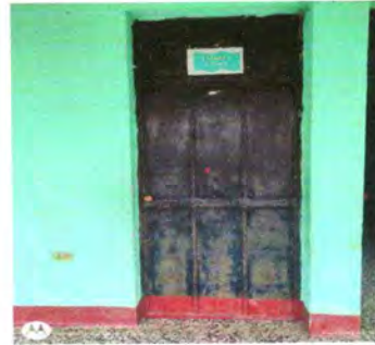
Foto 2: Puerta de metal en mal estado
