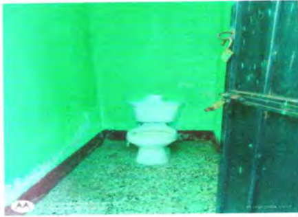
Foto 1: Servicios sanitarios deteriorados y paredes necesitan protección en azulejo
