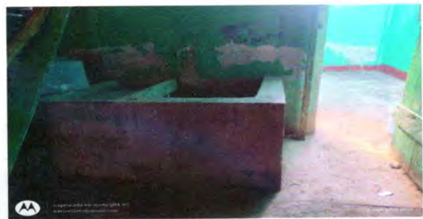
Foto 4: Piso de concreto en mal estado
