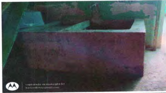
Foto 3: Pila de concreto artesanal le falta protección
