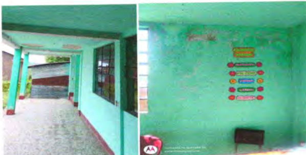
Foto 5: Repello en paredes y cielo de paredes deteriorado
