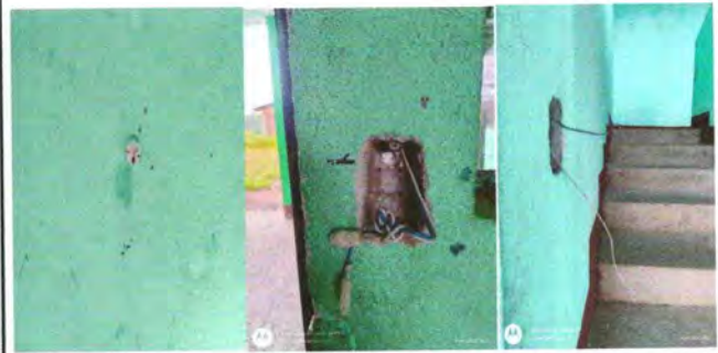
Foto 4: Sistema eléctrico general en malas condiciones y deteriorado
