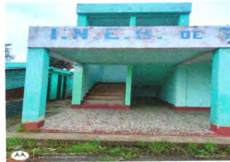
Foto 2: Falta de rejas de seguridad en gradas de acceso a terraza
