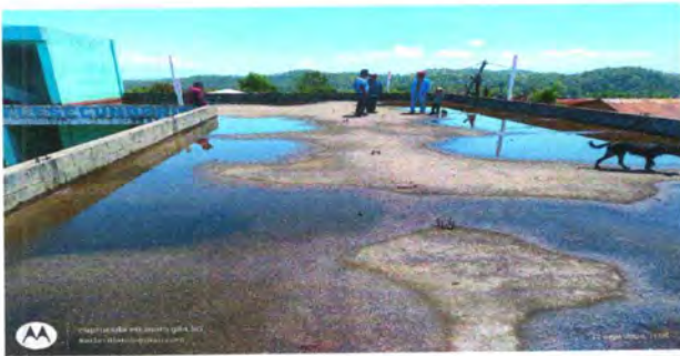
Foto 1: Losa de terraza en mal estado
