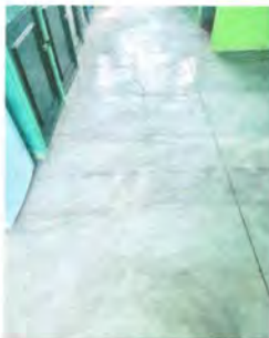
Foto 5: piso de cocina agrietado.
