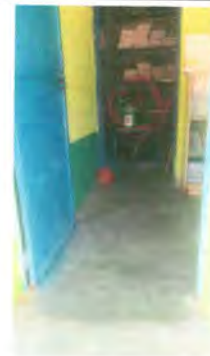
Foto 4: Piso de la Dirección en malas condiciones
