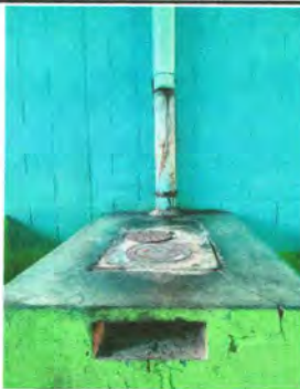
Foto 3: planchas artesanales y chumineas en malas condiciones.
