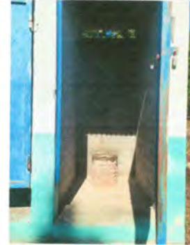
Foto 2: servicios sanitarios en malas condiciones.
