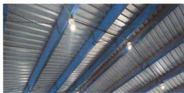
Foto 6: Lámparas led instaladas
