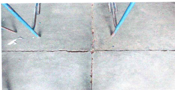
Foto 4: Piso de líquido deteriorado
