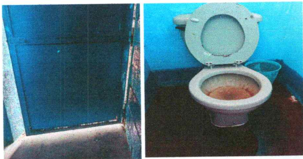
Foto 3: Puertas en mal estado de sanitarios y sanitarios deteriorados
