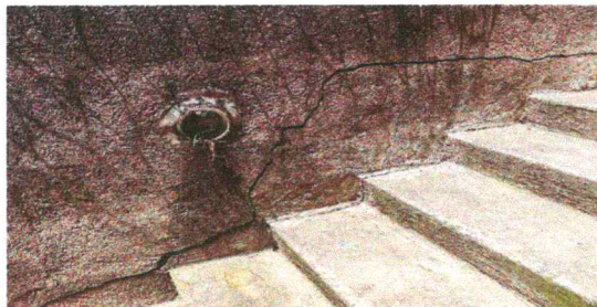
Foto 3: muro en mal estado
