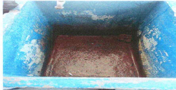
Foto 2: Pila en mal estado
