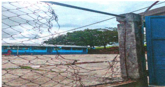
Foto1: Muro perimetral malla en mal estado
