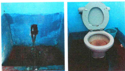
Foto 5: Paredes de baños dañadas por humedad
