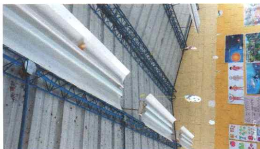
Foto 4: Instalando sistema eléctrico de todo el centro educativo deteriorado, lámparas no funcionan
