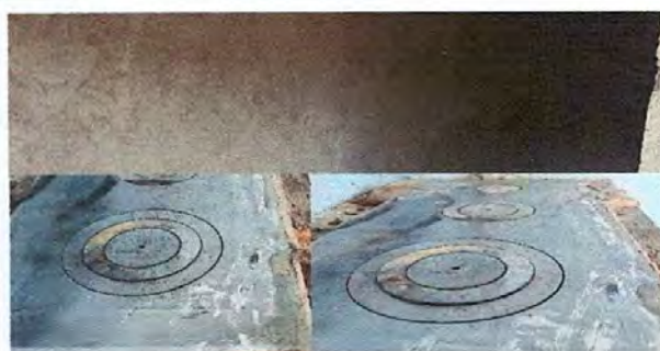
Foto 6: Estufas rurales nuevas instaladas
