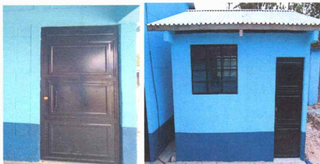
Foto 3: Puertas en aula y en cocina instaladas
