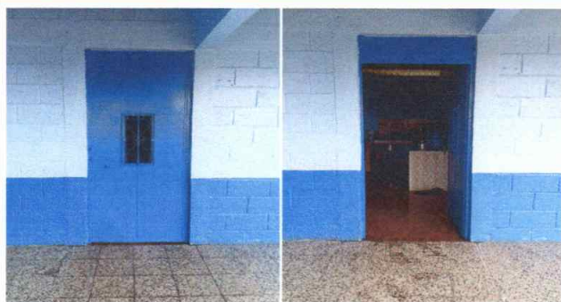
Foto 3: Puertas en mal estado
