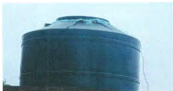
Foto 3: Depósito de agua deteriorado
