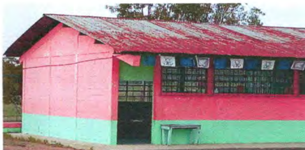
Foto 2: Estructura de soporte de metal deteriorada
