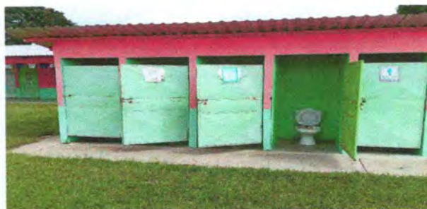
Foto 2: Paredes de baños expuestas sin protección falta de azulejo
