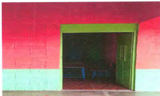
Foto 3: Puertas en mal estado
