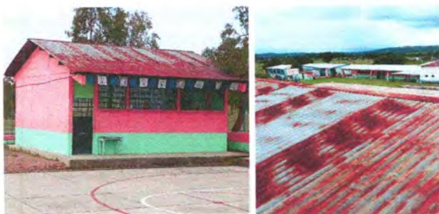
Foto1: Cubierta de lámina en mal estado
