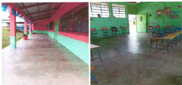
Foto 5: Piso de cemento líquido deteriorado
