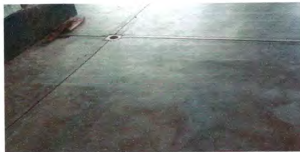
Foto 2: Piso en malas condiciones en cocina
