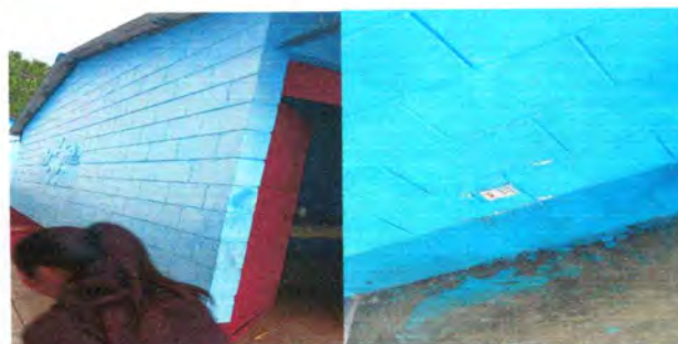
Foto 6: Pintura en malas condiciones
