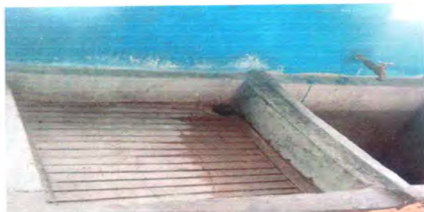
Foto 5: Pila en mal estado
