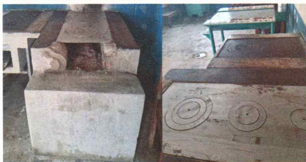
Foto 5: Plancha de metal de tres hornillas instalada
