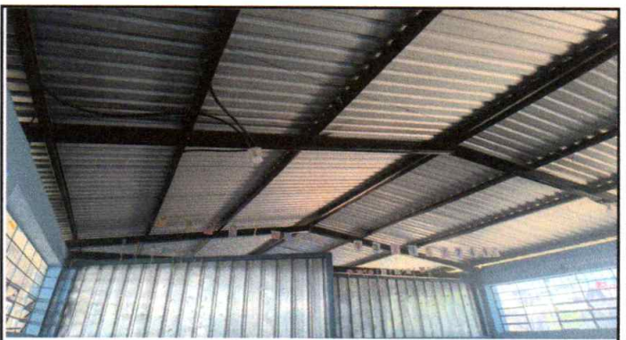
Foto 10: Sistema Eléctrico Instalado
