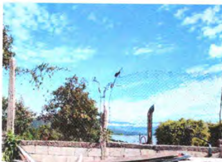
Foto 11: Muro perimetral arruinado
