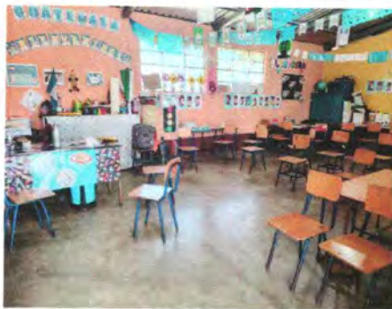
Foto 9: Aulas con piso de concreto deteriorado
