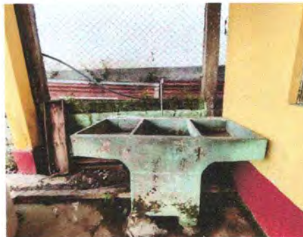
Foto 2: Pila en malas condiciones
