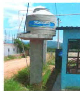
Foto 6: Depósito de agua deteriorado
