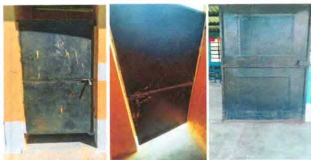
Foto 3: Puertas en mal estado
