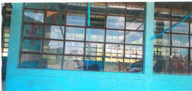
Foto 5: Ventanas expuestas falta de seguridad sin balcón
