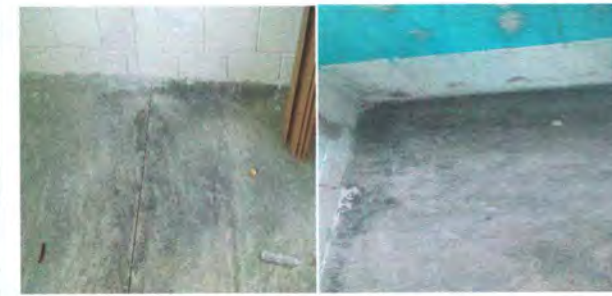
Foto 6: Piso de cemento liquido en mal estado
