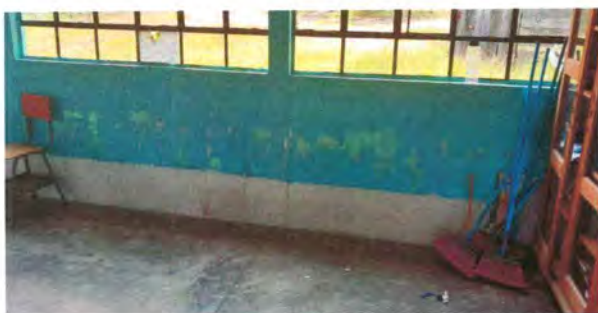
Foto 3: Pintura deteriorada en todo el centro educativo
