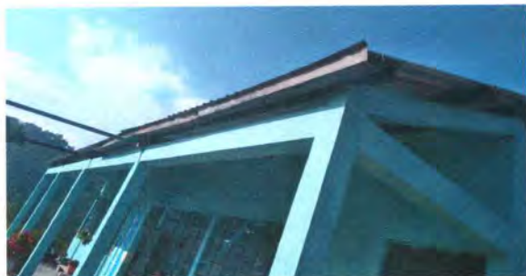
Foto1: Canales de metal deteriorados
