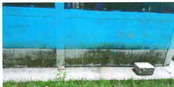
Foto 2: Pintura deteriorada en todo el centro educativo
