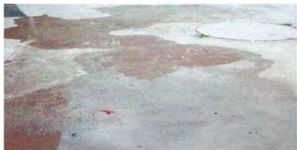
Foto 3: Torta de cemento en mal estado
