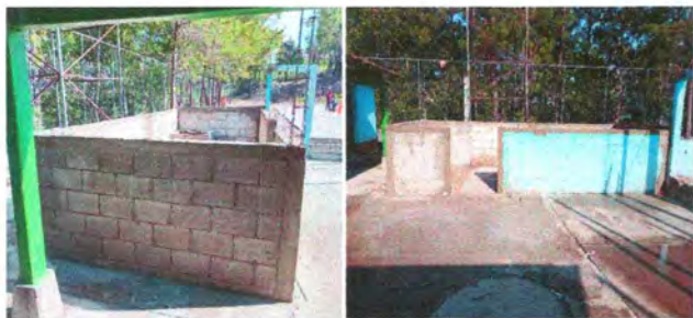
Foto 5: Cocina inadecuada para manipulación, elaboración y cocción de alimentos
