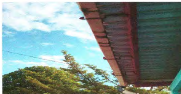
Foto 4: Canales en mal estado
