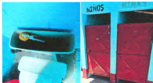
Foto 6: Kit de sanitarios dañados y pasadores de puertan en mal estado
