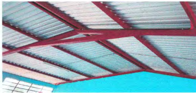
Foto 2: Estructura de soporte de metal deteriorada
