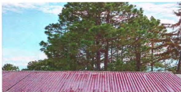
Foto1: Cubierta de lámina en mal estado
