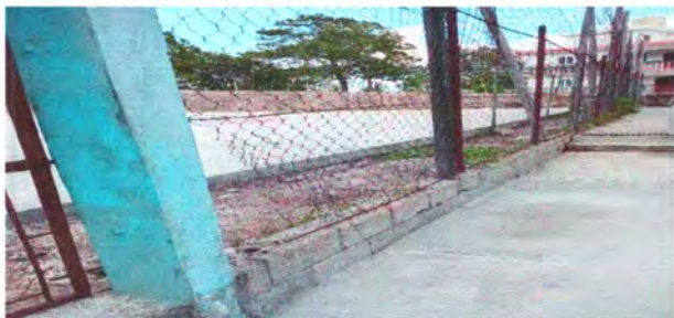
Foto 1: Malla en mal estado, block y columnas deteriorados
