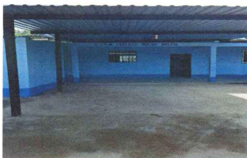
Foto 3: Losa de patio deteriorada
