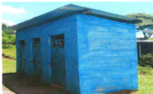
Foto 4: Puetas de servicios sanitarios detereoradas
