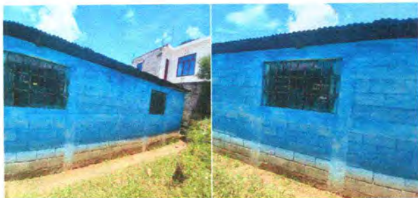
Foto 5: Ventanas detereoradas y vidrios quebrados
