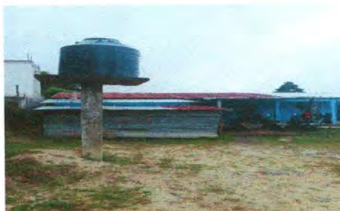
Foto 4: Depósito de agua sin tapadera y base de concreto en mal estado
