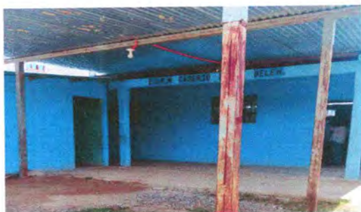
Foto 3: Losa de patio deteiorada
