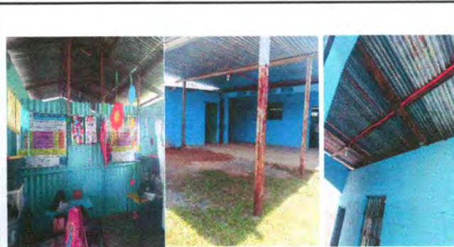
Foto 2: Estructura de techo en mal estado
