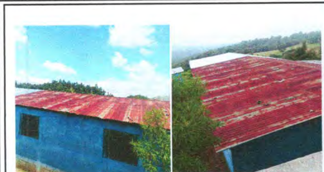
Foto1: Cubierta de lámina detereorada
