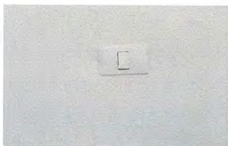
Foto 5: Sistema eléctrico instalado y terminado
