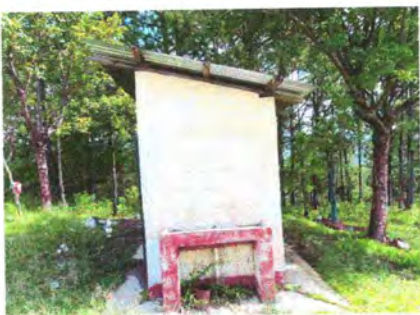
Foto 1: La lámina se encuentra deteriorada
