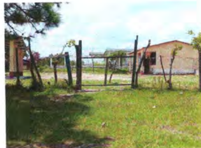
Foto 4: Muro perimetral deteriorado
