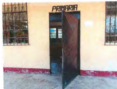
Foto 4: La puerta de aula esta dañada
