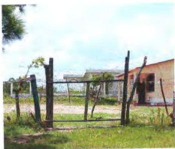
Foto 5: El portón se encuentra en mal estado
