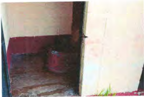
Foto 3: Los sanitarios en mal estado
