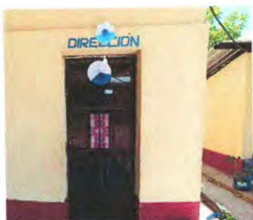
Foto 3: La chapa esta dañada
