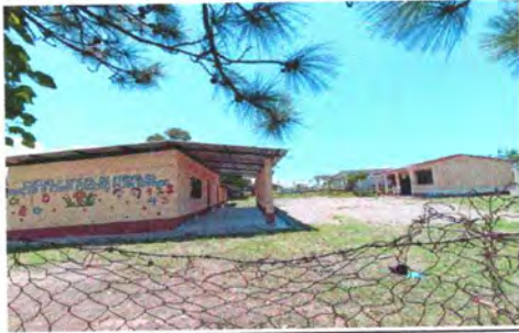
Foto 1: La pintura se encuentra deteriorada
