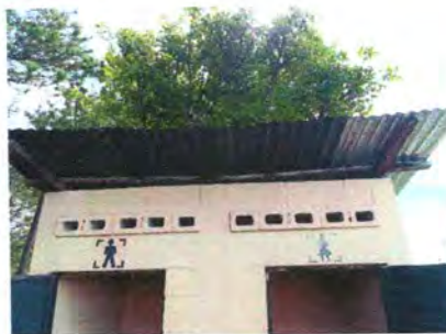
Foto 2: La estructura de techo esta dañada
