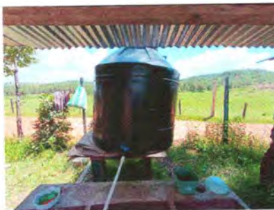
Foto 5: Depósito en mal estado
