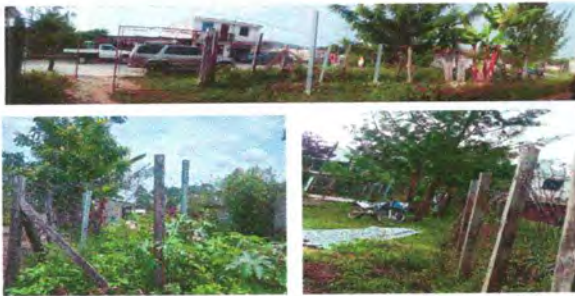
Foto 3: Muro perimetral en mal estado frente al portón calle de via pública pavimentada
