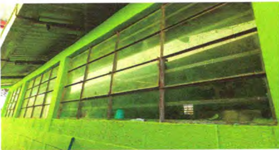
Foto 3: Ventanas y vidrios en mal estado
