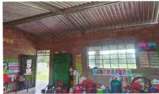
Foto 4: Aulas no cuentan con sistema eléctrico
