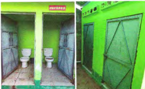
Foto 5: Puertas de sanitarios en mal estados
