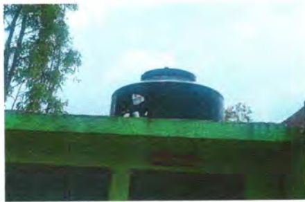
Foto 5: Depósito de agua en mal estado
