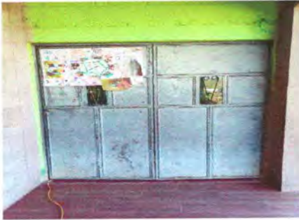
Foto 1: Portón de salón en mal estado
