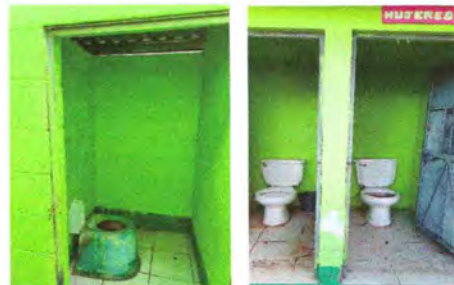
Foto 6: Inodoros en mal estado
