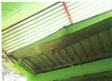
Foto1: Canales de recolección de agua en mal estado
