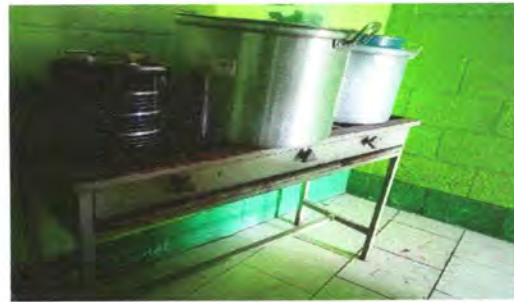
Foto 6: Cocina en las paredes manchas por vapor de cocción de alimentos y no se cuenta con muebles para colocar utensilios de cocina
