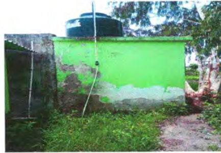
Foto 2: Paredes de baños deteioradas por humeda de adentro hacia afuera
