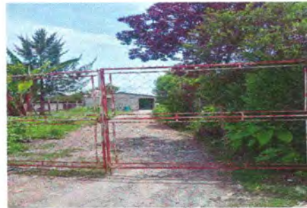
Foto 2: Portón en mal estado del muro perimetral
