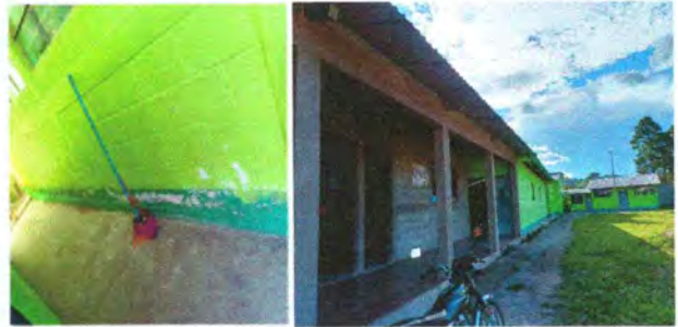
Foto 4: Pintura deteiorada y aulas sin pintura
