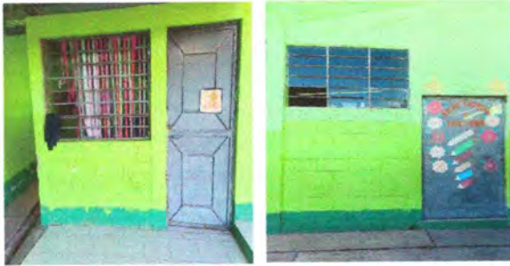
Foto1: Puertas en mal estado
