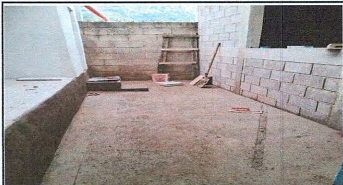
Foto 9: Cernido de columnas.
