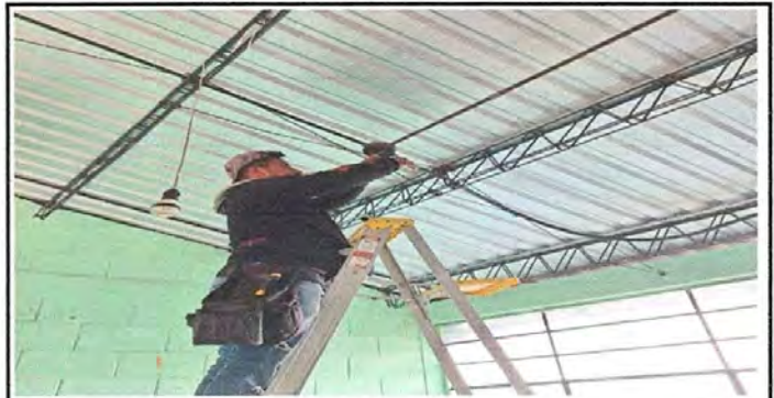
FOTO 6: Sustrucción de plafoneras
