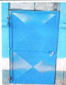
Foto 3: Sustrucción puerta de aula
