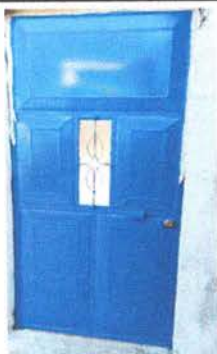
Foto 5: Sustrucción puerta de bodega de cocina
