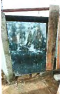
Foto 5: Sustrucción puerta de bodega de cocina
