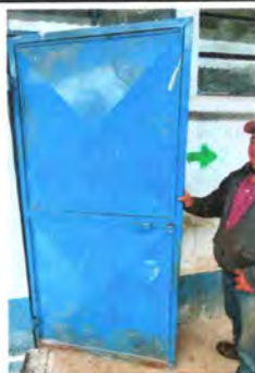
Foto 3: Sustrucción puerta de aula
