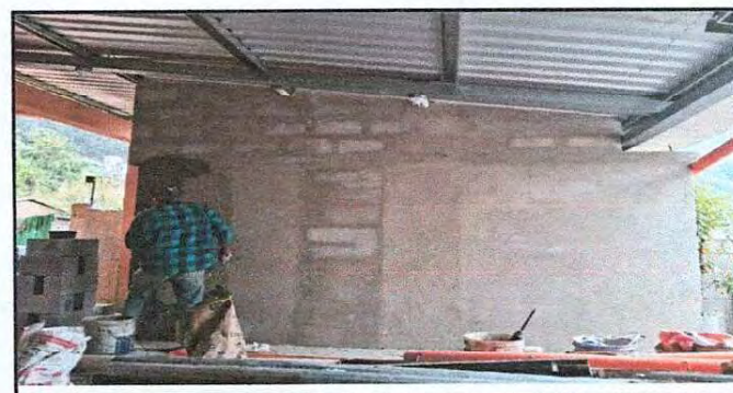
Foto 12: Repello de pared de esecario.
