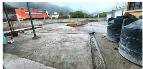
Foto 2: Sustrucción de piso de torta de concreto.
