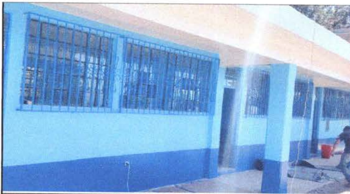
Foto 3: BALCONES EN VENTANAS
