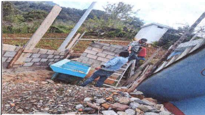
Foto 3: PUERTAS DE METAL
