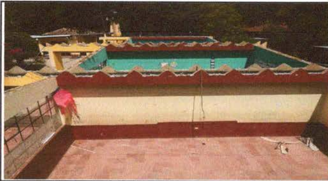
Foto 1: Techo en mal estado desechado.
