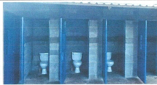
Servicios sanitarios y accesorios
