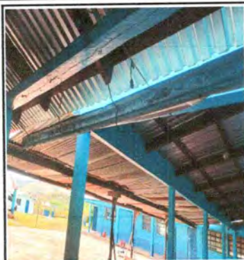
FOTO 7: Sustrucción de Canal de Metal
