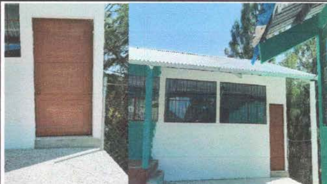
Foto 2: Sustrucción de puerta de metal de aula
