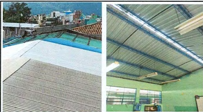
Foto1: Cubierta de lámina por deterioro en cocina y aula de la par de la cocina pues entra demasiada agua.
